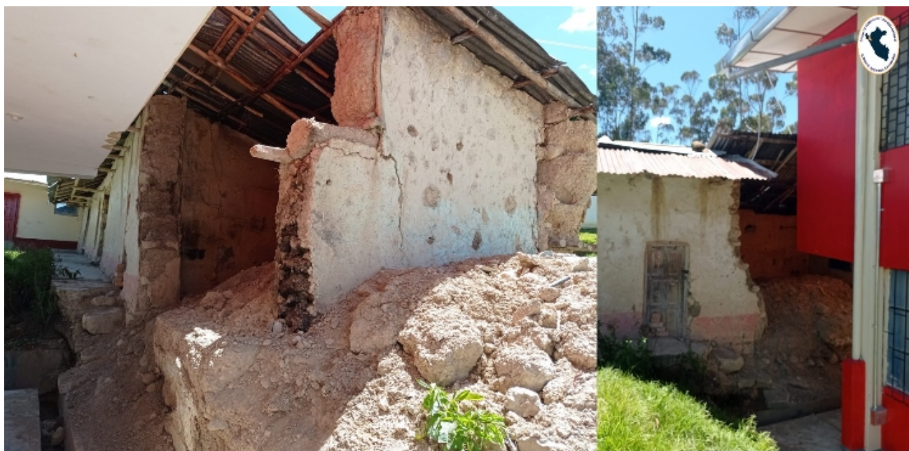
Evaluación de daños y otras necesidades para reconstrucción de aulas de la I.E N° 82710 del C.P La Colpa, Distrito de Bambamarca.
