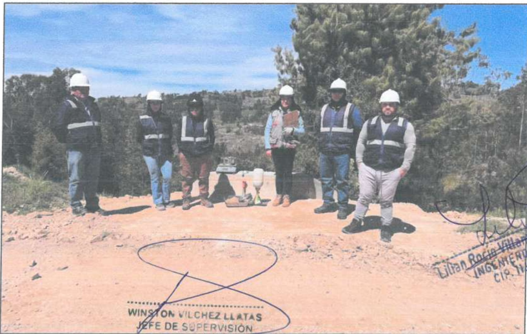
Fotografía N° 02: Supervisión del ensayo de densidad de campo en relleno de cabezales de alcantarillas
