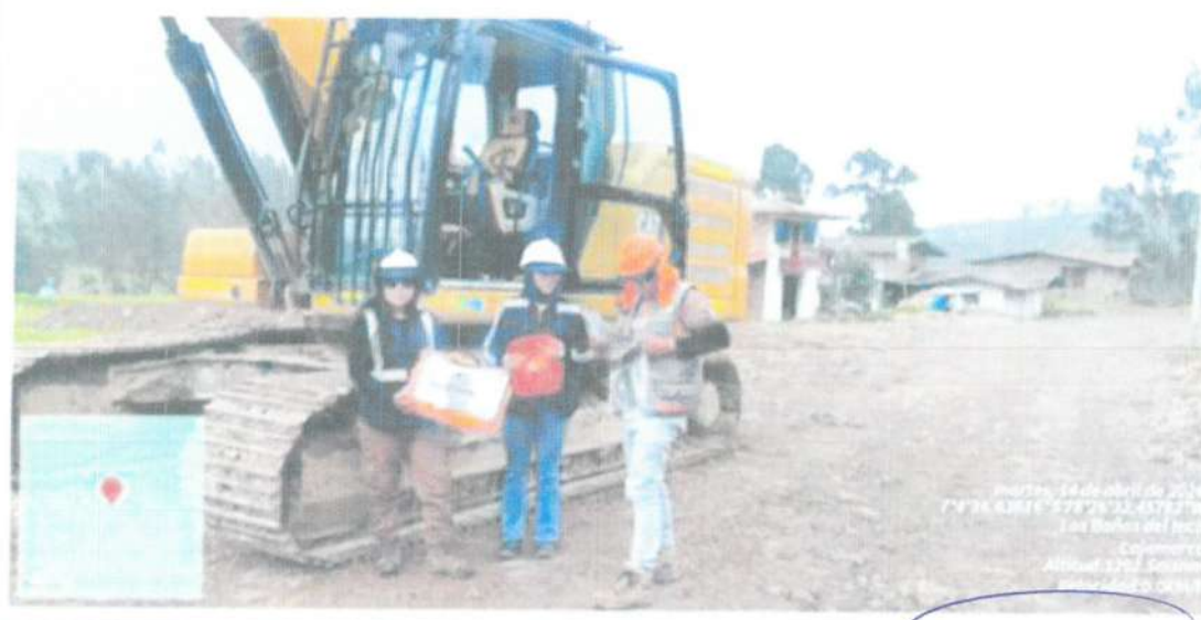
Ilustración 2. Inspección de Kit antiderrames y botiquín.
