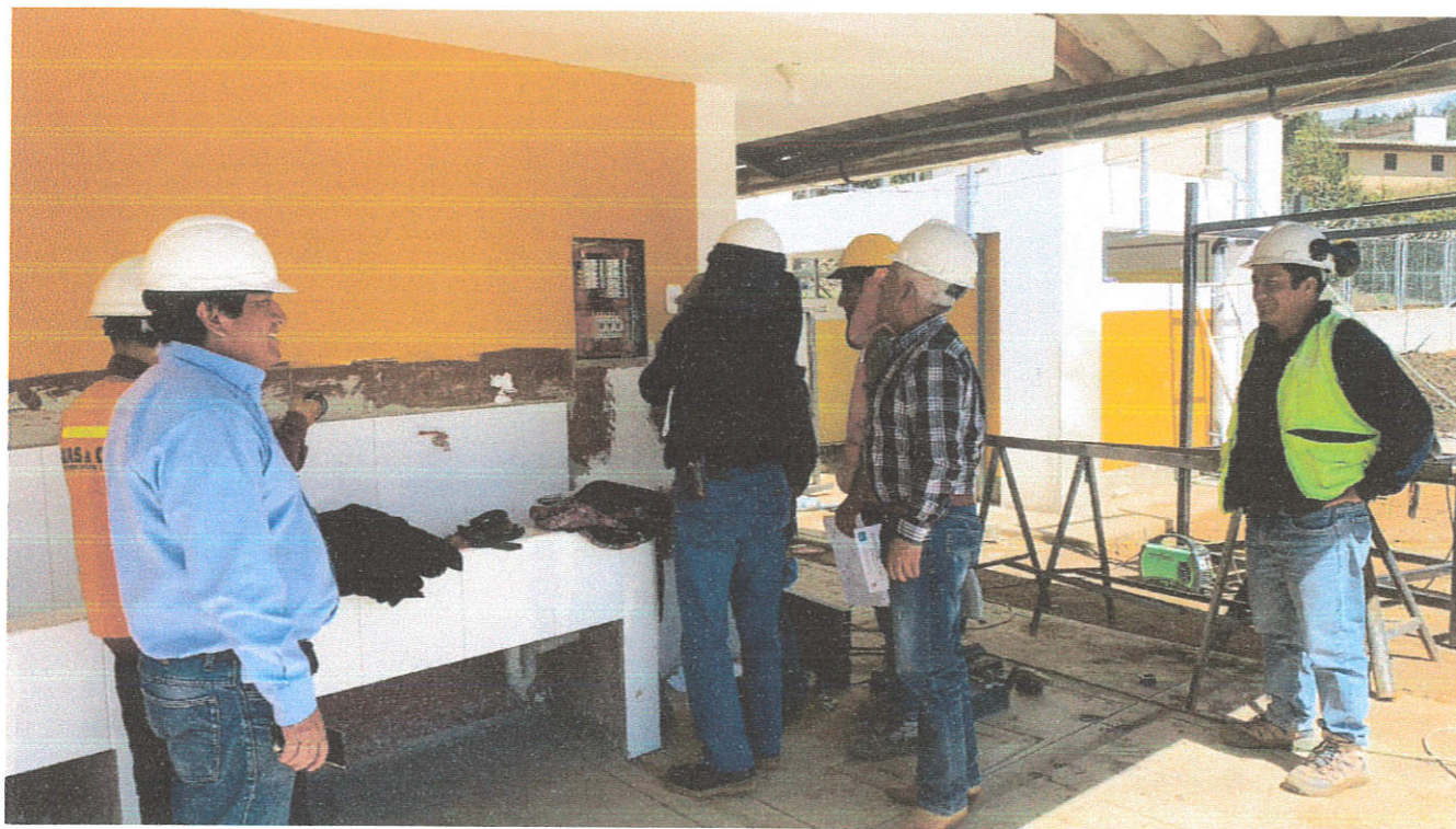
Fotografía N°12: Verificación del cableado eléctrico con Residente, Supervisión y Sub Gerente de Supervisión y Liquidaciones.
